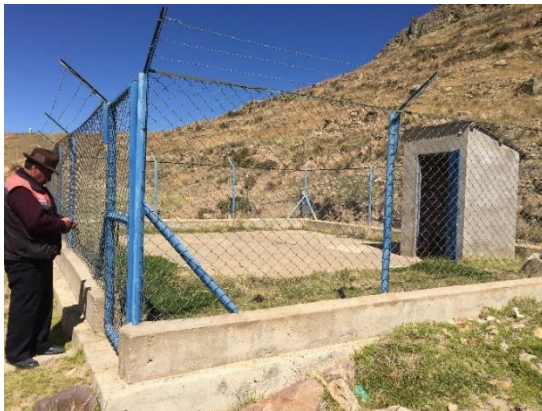
Sistema de bombeo para agua potable
